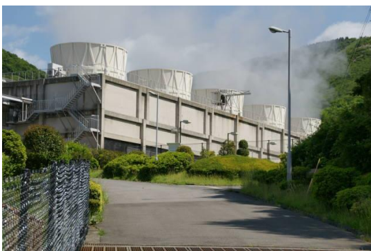
図2 八丁原地熱発電所(大分県九重市)
